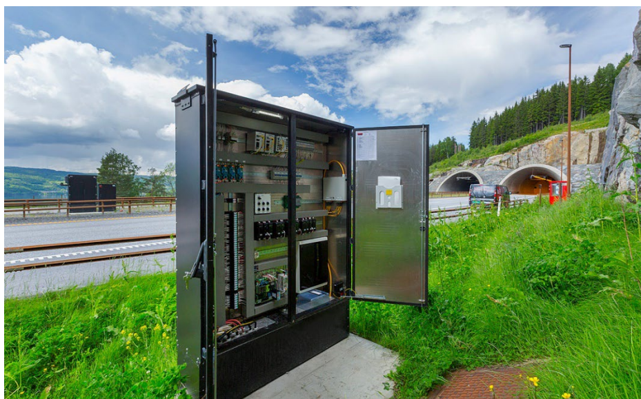
Figur 9-1 Et typisk styreskap ved tunnelmunning
