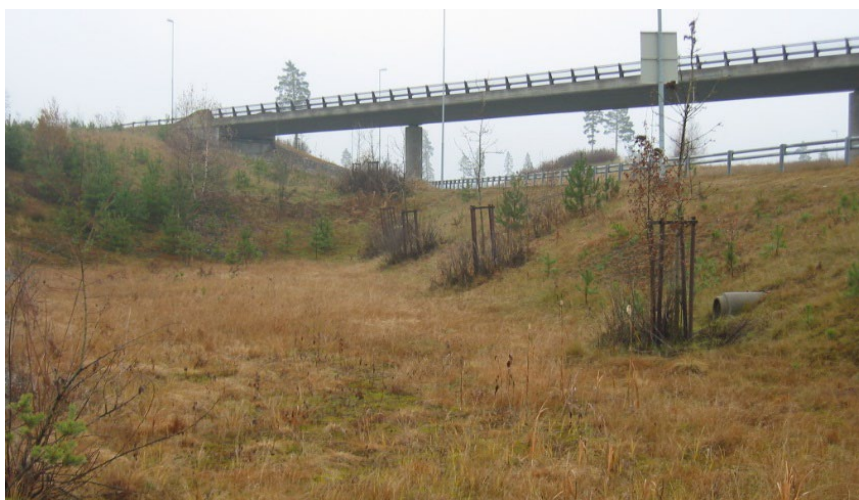
Figur 6-5. Infiltrasjons-/filterbasseng langs hovedvei (trinn 1+2 rensing). Innløpet ligger til høyre i bildet (Foto: COWI AS).
