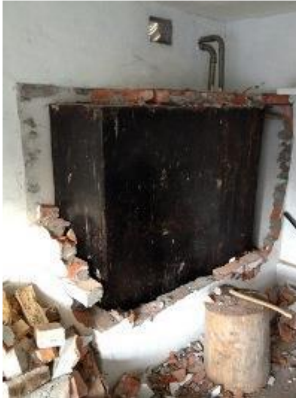
Tank over bakken innmurt i garasje. Foto: Kristin Skjelbred.
