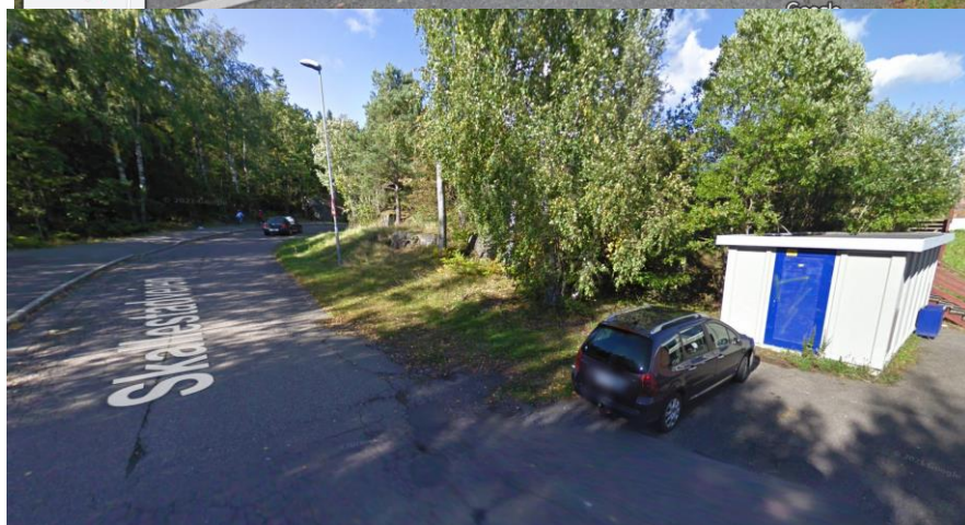
Trafo langs Hagabergveien , mot kryss til Bergveien og en ved Hårkollhallen.
