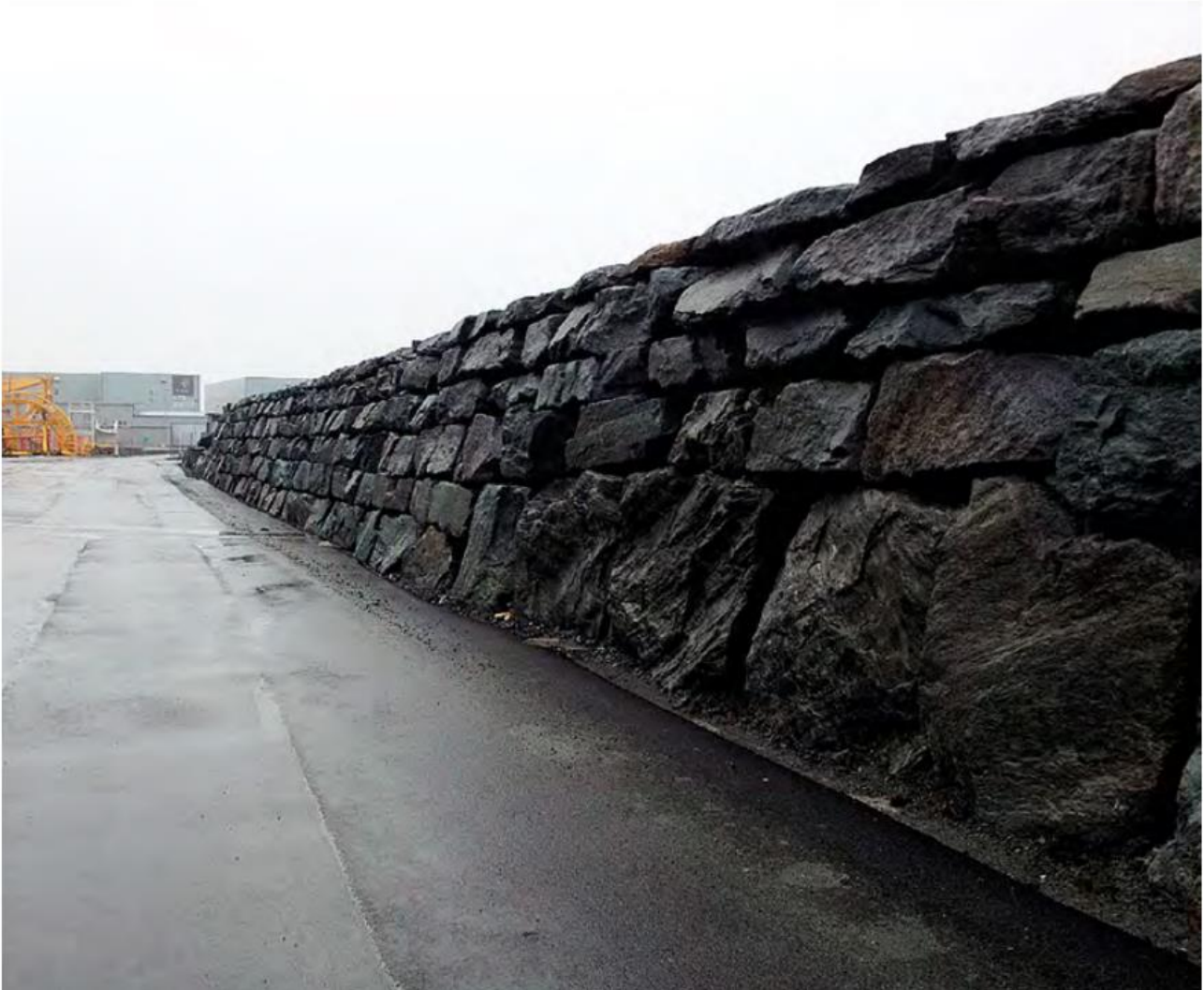
Figur 22 Innside av bølgevern murt med steinblokker. Bildet viser brystvern på Killingøymoloen i Haugesund og er hentet fra Molohåndboka. Merk at bølgevernet på Mostranda blir noe lavere (og kortere) enn vist på bildet.
