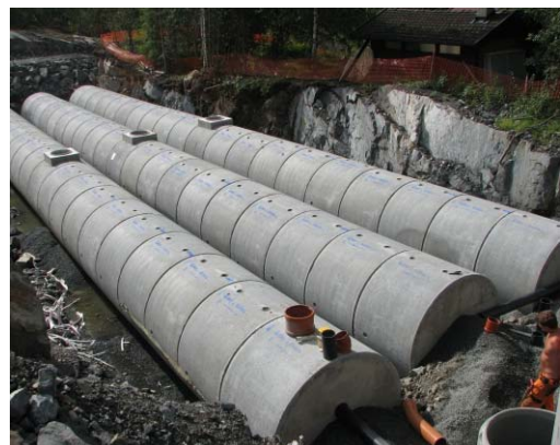
Eksempel på fordrøyning i rørmagasin (foto: Basal AS).
